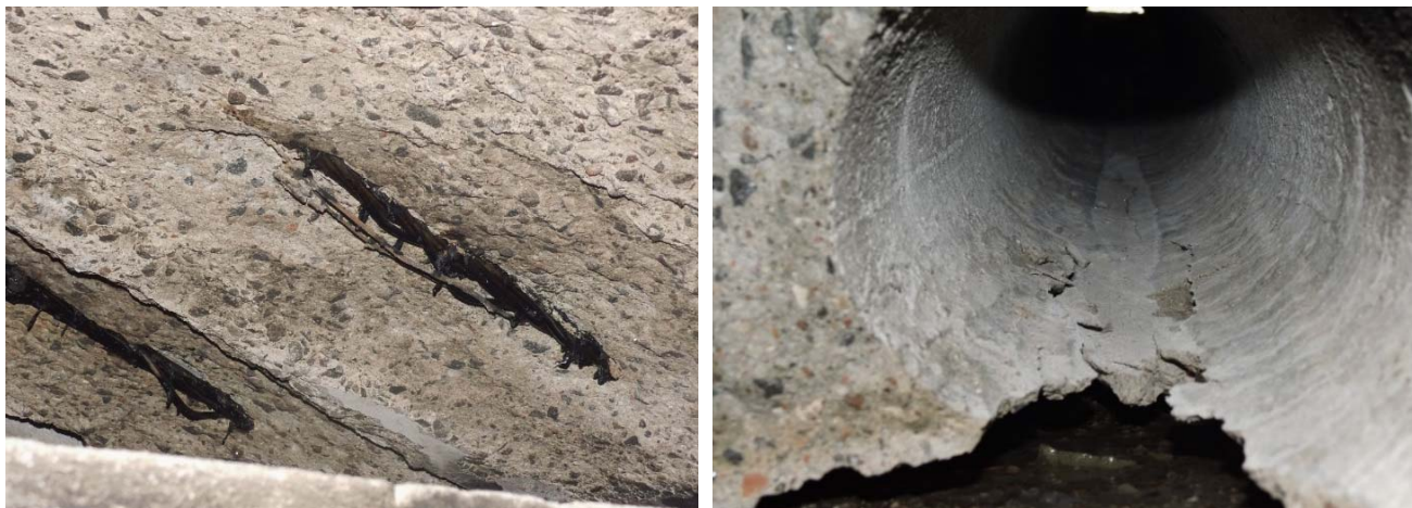
Рисунок 6. – Разрушение защитного слоя бетона экспериментальных образцов
