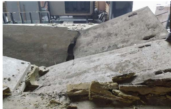
Рисунок 9. – Фото разрушения железобетонных плит
